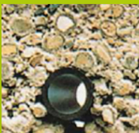
Jastrych cementowy Element ogrzewania podłogowego zatopiony w jastrzuchu cementowym
