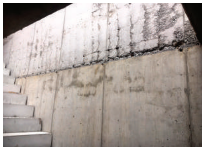
Fot. 4. Źle wykonane elementy betonowe klatki schodowej
